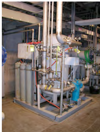
•Reuse NBPS DI Water skids
